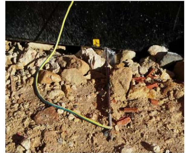
Toma de tierra defectuosa, mal conectada
